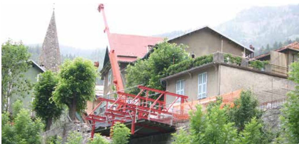
Portique pour extension route de montagne
